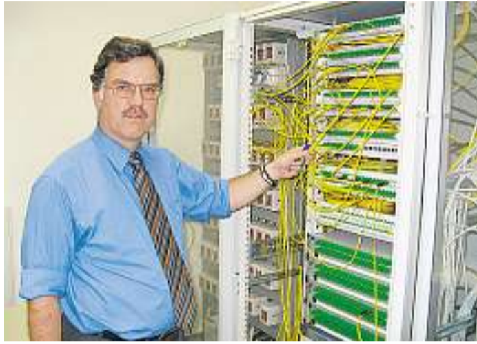
ODR TSG-Geschäftsführer Werner Riek an einem Schaltschrank des Lichtwellenleiternetzes in der Firmenzentrale in Ellwangen. (Fotos: sk)
